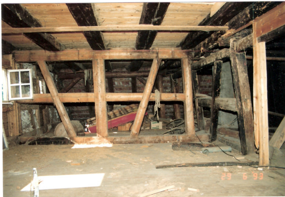
Foto 33: Dachgeschoß über dem westlichen Erweiterungsbau von 1773 ff.. Auffällig ist, daß die starken Verformungen des originären Gefüges des Kernbaus im Anbau nicht mehr zu verzeichnen sind. Die rußgeschwärzten Deckenbalken sind hier in Zweitverwendung. Rechts im Bild der alte Fassadenabschluß des Kernbaus (vergl. Foto 20).
