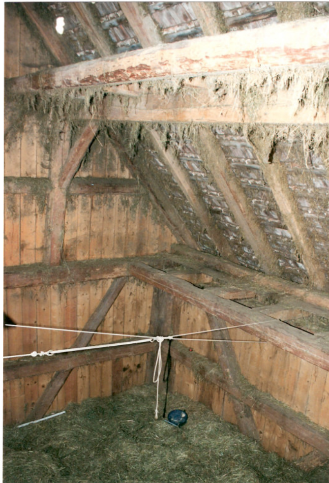
Foto 18: Ausschnitt des Bergeraums in südöstlicher Richtung. Die Holzkonstruktion des östlichen Anbaus von 1707 ff. zeigt verzapfte Verbindungen. Die Stichbalkenkonstruktion deutet darauf hin, daß der Anbau von vornherein offen geplant und erbaut wurde.
