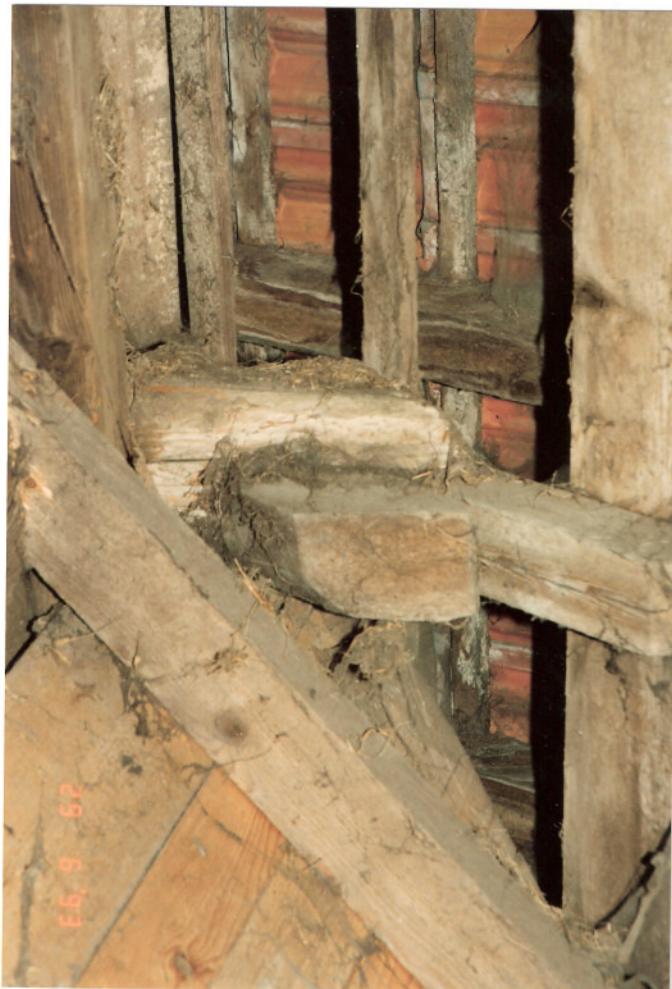
Foto 10: Detail eines Sparrenkopfes (vergl. Foto 9), der mit dem Deckenbalken überblattet ist und zur ursprünglichen Dachkonstruktion des Kernbaus von 1540 ff. gehört.
