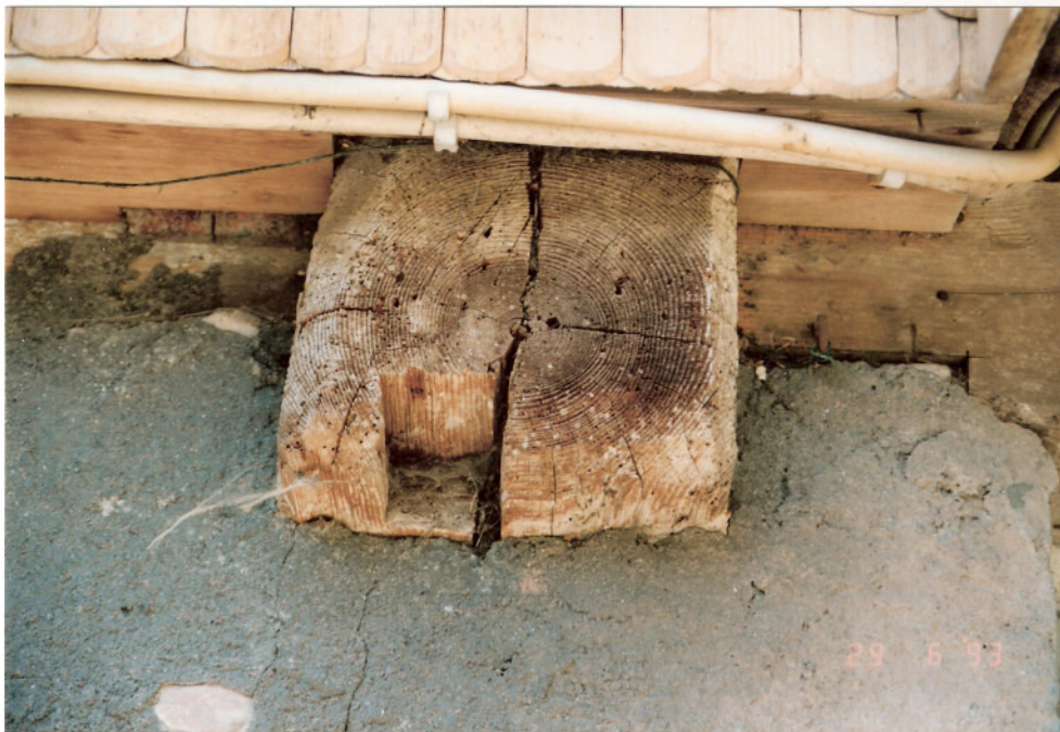
Foto 8: Detailansicht eines Balkenkopfes mit Ausnehmung. Das Erdgeschoß bestand ursprünglich vermutlich aus einer Fachwerkkonstruktion und wurde frühzeitig durch einen massiven Sockel ersetzt.
