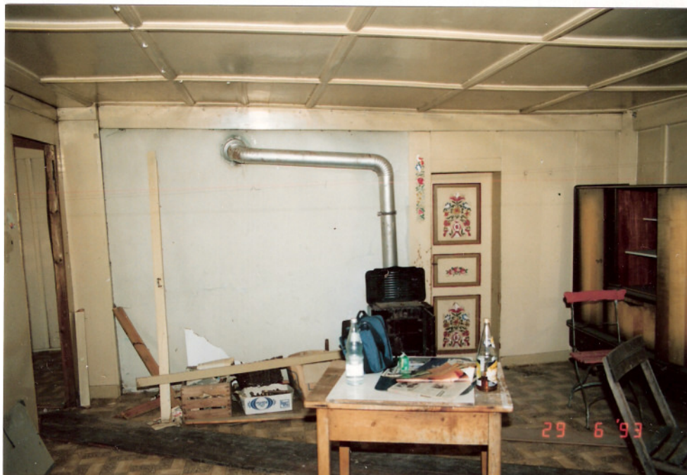
Foto 22: Blick in die ehemalige Stube des Hauses. Vor der Trennwand zur Küche stand ehemals anstelle des kleinen Kohleofens ein großer gußeiserner Ofen.
