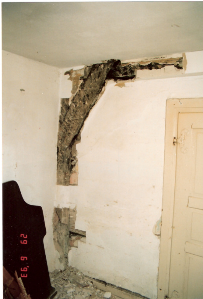
Foto 26: Südwestlicher Ständer in der Küche mit angeblattetem Kopfband belegt ursprüngliches Wandgefüge.
